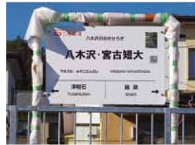
新設された「八木沢・宮古短大」の駅名標。移管日ギリギリまで工事が続く
